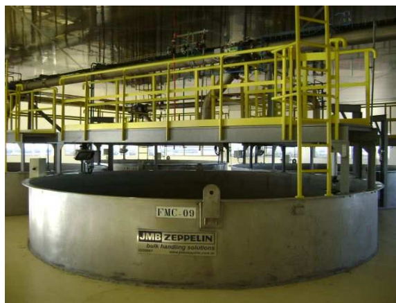
Tanque de maceração
